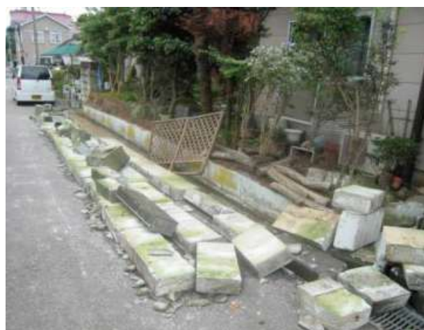
倒壊した石塀
