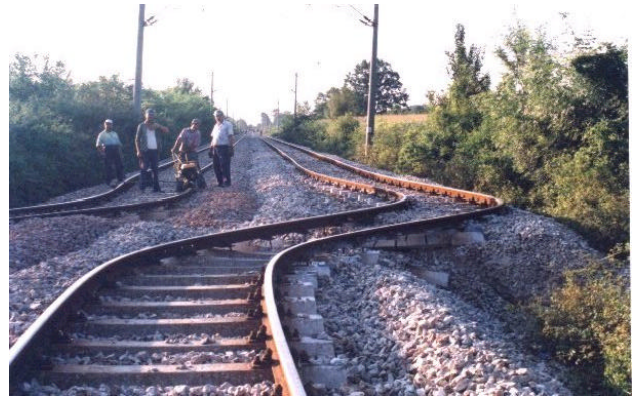
写真4 断層変位にともなう盛土とレールの蛇行。右ずれの変位量は約 2.5m (インターネットより)。
