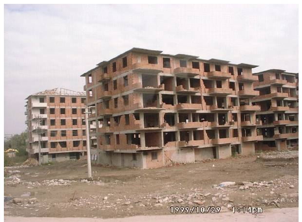
写真3 この地域で典型的に見られる RC 造建物。建設中に被災したものと思われ，倒壊は免れているがレンガが剥落している（ギョルジュク）。
