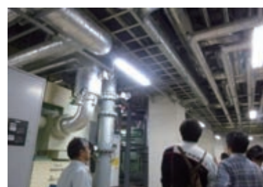
大学病院 ボイラー等の見学
