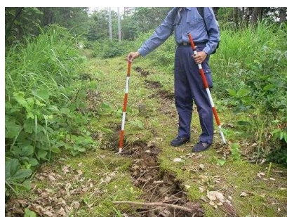
のり面上部の開口クラック
