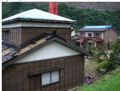
谷根川沿い低地の住宅被害状況
