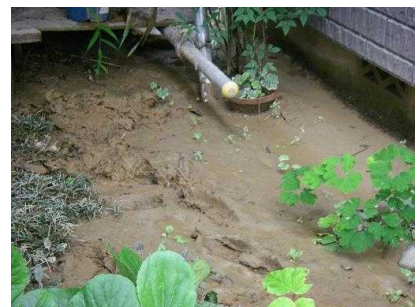
宅地内の噴砂（築 S45 年建物問題無し）
