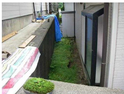
擁壁がズレて隣の宅地に乗り上げている
