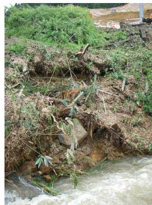
崩壊土砂の洗堀状況
