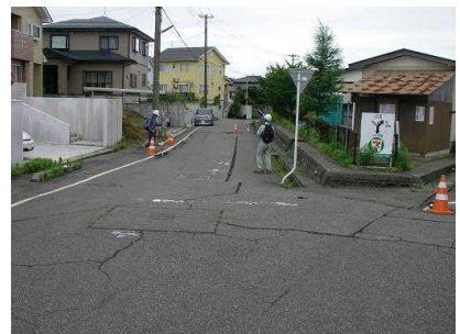
谷埋め盛土部分が沈下変状
