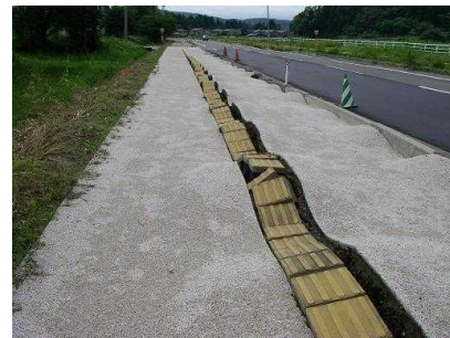
道路の路面が規則正しく波型に変状
