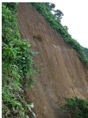
青海駅脇の滑落崖(段丘層)
