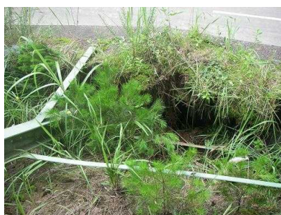
擁壁頂部の背面（口が空いている）
