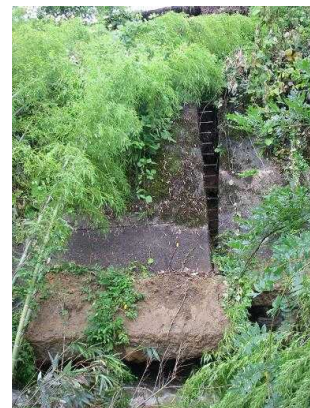
崩壊した道路盛土の土留め壁 (基礎部分の洗堀が進む)
