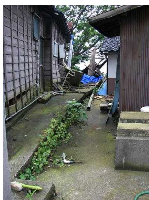
滑落崖直上の住宅の変状(奥は崖) 写真右の矩形は掘り抜き井戸で、 段丘層内の地下水を利用している。
