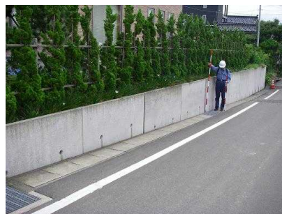
緩傾斜方向にズレ、沈下
