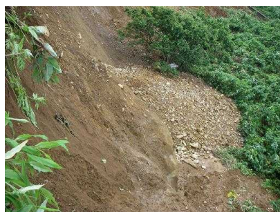
余震によるとみられる崩積土砂 (崖の変局部より地下水が湧いている)
