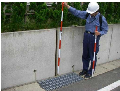
宅地擁壁のズレ
