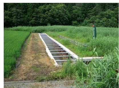
田んぼの鋼矢板水路には変状が見られる
