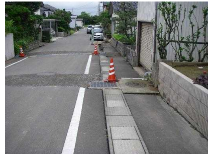
街路の変状（緩傾斜に沿って流動）
