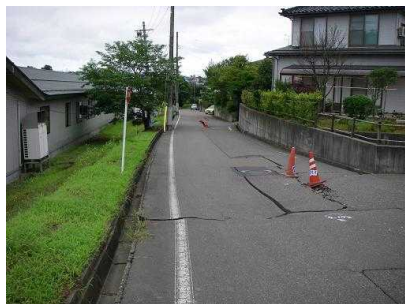
谷埋め盛土が傾斜に沿って変状
