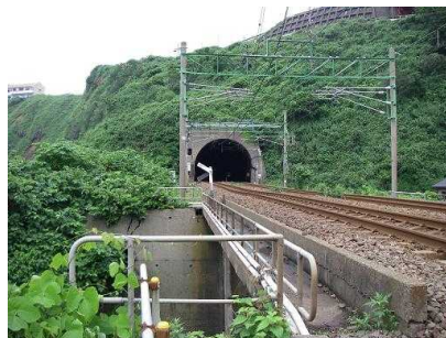
谷根川橋梁とトンネル間の盛土の沈下
