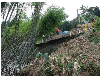
崩壊した歩道 (歩道上には作業員がいる。黒川の洗堀による盛土の崩壊が心配された。)
