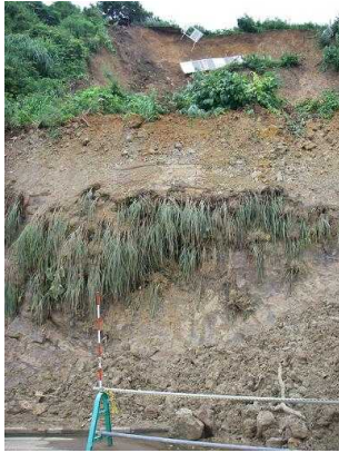
海岸斜面の段丘層の崩壊 (第三紀層の上面より湧水)
