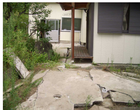
中越地震による宅地被害状況
