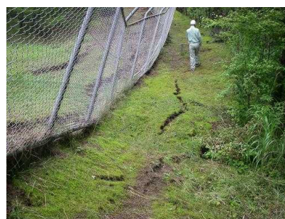
のり面上部には開口クラックが多発
