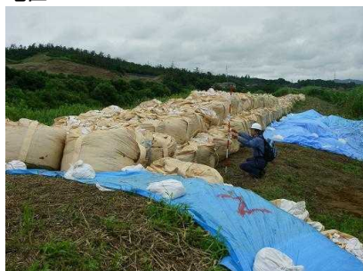
堤防防の沈下(旧河道部では 1.2m)
