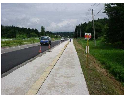
宅地(右)側には側方変位が少ない
