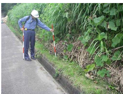
のり面のはらみ出し (奥に見える土嚢積工が擁壁部分)
