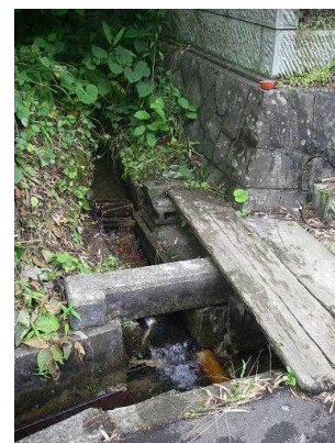
地下水位が高い (住宅脇の排水路)
