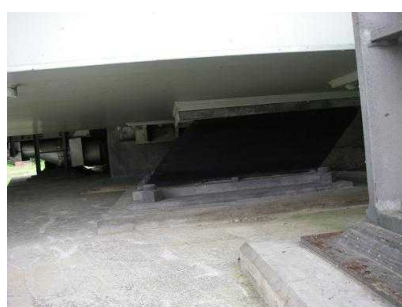
国道 8 号線鯖石川橋台の弾性支承（積層ゴム）の変形
