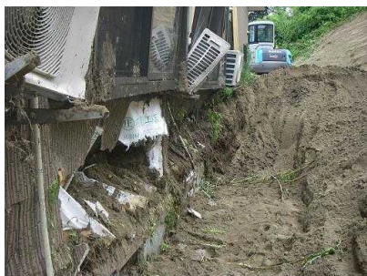
住宅の背面の被災状況
