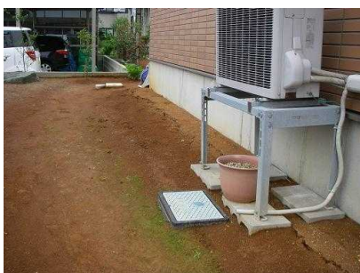
新築建物の基礎周りの沈下
