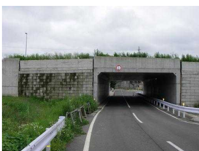
国道 8 号線鯖石川橋台と管渠間の沈下
