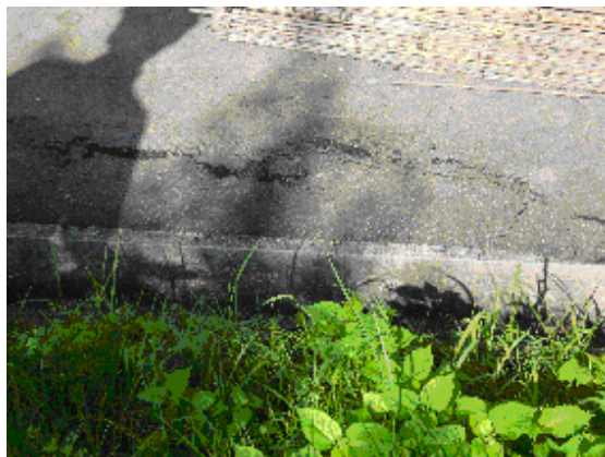
図4 地すべり部分と建物の間の地面の盛り上がり
