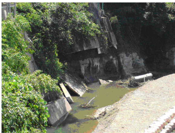
図 11 コンクリート護岸崩落部分
