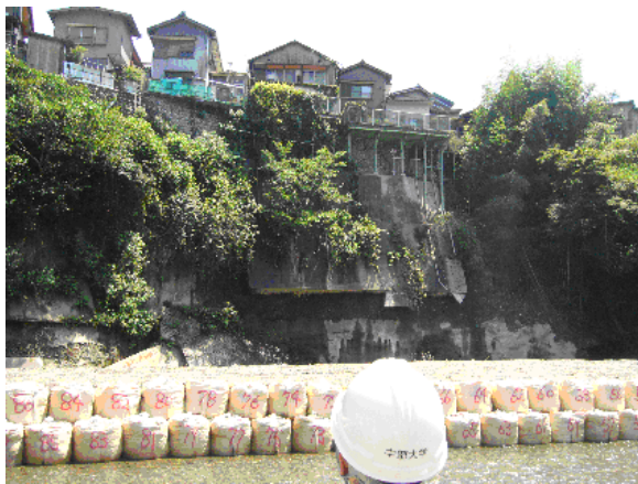
図 10 荒川コンクリート護岸の被害
