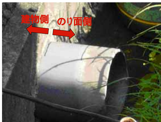
図5 押し出しにより露出した配水管 こののり面は、もとは切土のり面であったが、
