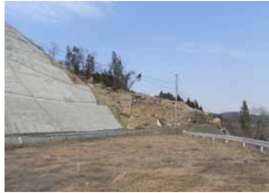
図4 国道342号線下真坂地区の斜面崩壊
