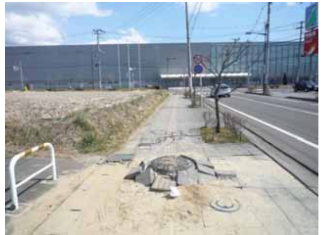
図2 白石市内の液状化による被害
