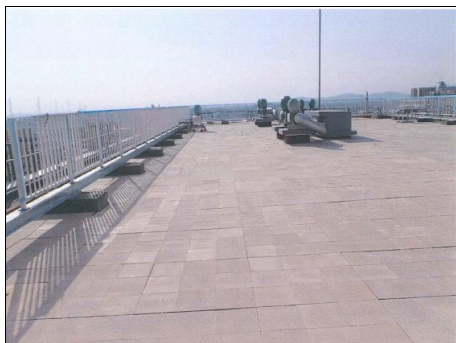
建物の高断熱化
