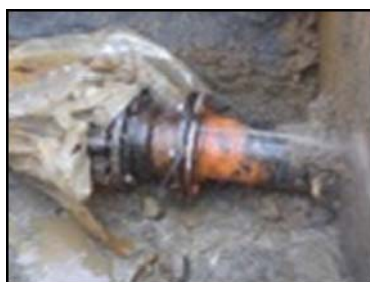
図-20(b) 給水管の腐食による漏水
