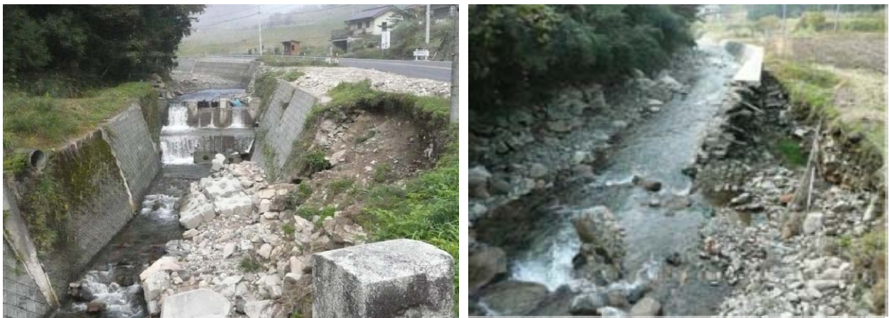
写真 1 山間小河川における立ち護岸(左・右)と護床工(右)の被災状況 (由良川水系佐々木川)
