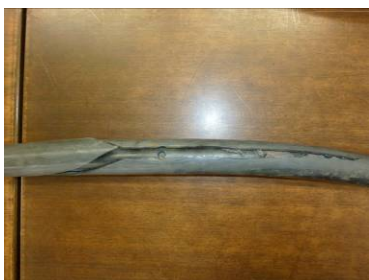
図-20(a) 高圧ケーブルの老朽化による被覆破断
