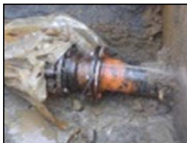
図-20(b) 給水管の腐食による漏水
