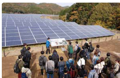
岐阜市メガソーラー発電施設の見学
