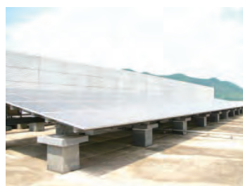
（写真 1）太陽光パネル
