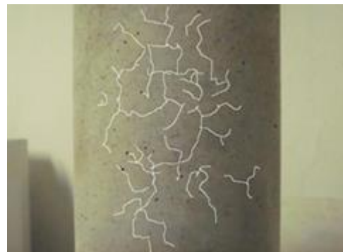
図-2 500°C加熱によるひび割れ状況
