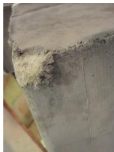
写真-9 HPFRCCの角つぶれ
